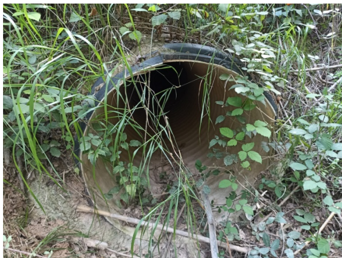
Imatge 49. Fotografies de l'estructura hidràulica del T. Salt de Can Llopard
